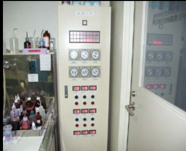
気圧モニター盤
